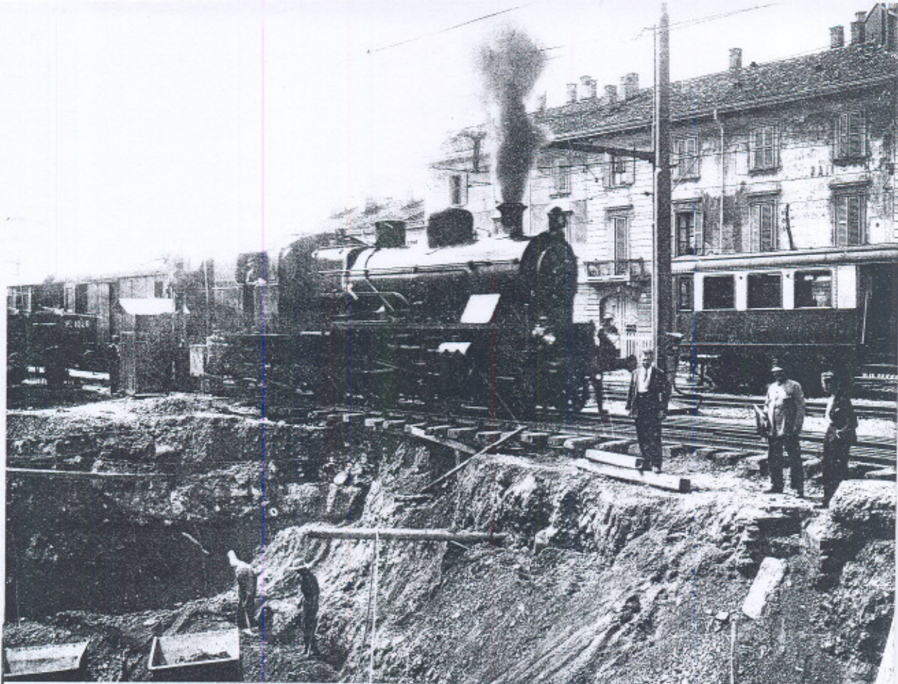
Stazione di Saronno, nel 1929: inizio dei lavori per la costruzione del sottopassaggio del Viale del Santuario. Foto Longoni
